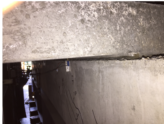
(d) PTB1-2 Delamination of Interface
