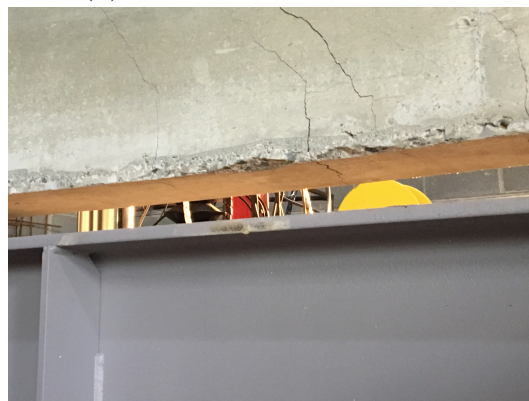
(d) PTB2-1 Cracks Underneath the Beam
